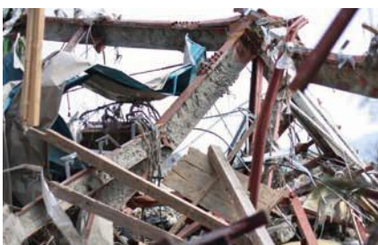
被災地で倒壊した建築物に混在する吹付け材
