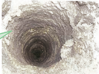
煙突内部のアスベスト断熱材
