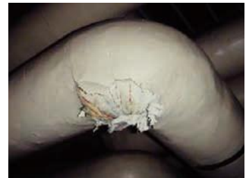
配管エルボの保温材
