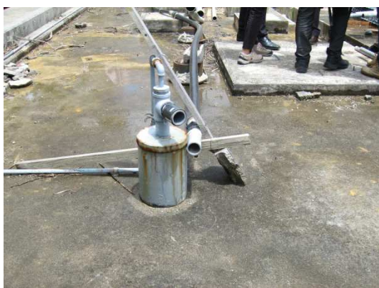
図2 St.①の既設揚水ポンプ
