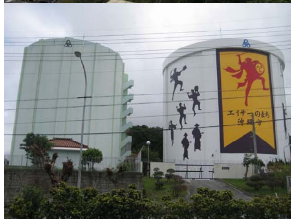
高台に位置する配水池 上：胡屋配水地 下：八重島配水地
