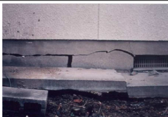
出典：被災建築物応急危険度判定マニュアル
