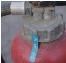
× キャップの劣化
