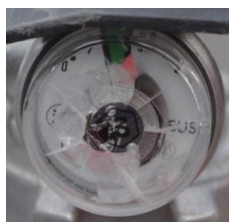
× 指示圧力計の損傷
