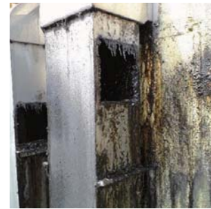
排出口の油污れ
